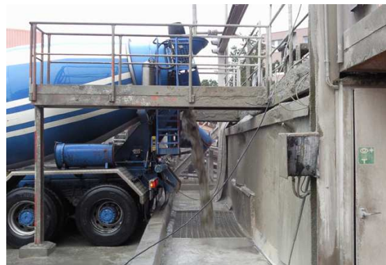
Einlaufrinne mit Spülgalgen für 4 Fahrmischer gleichzeitig
