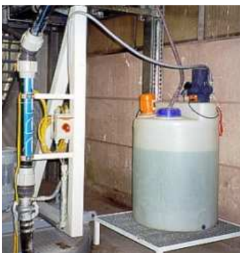
Flockungsmitteldosierstation Zur Beschleunigung der Sedimentation von Schwebepartikeln (z.B. Farbpigmenten) wird Flockungsmittel eingesetzt. Dies erhöht die Durchsatzleistung.
